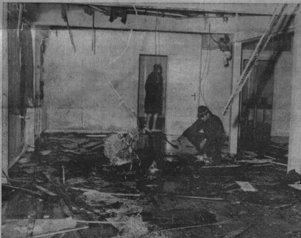
Unser Bild zeigt einen durch Feuer und Wasser stark beschädigten Raum der »Arche«.
