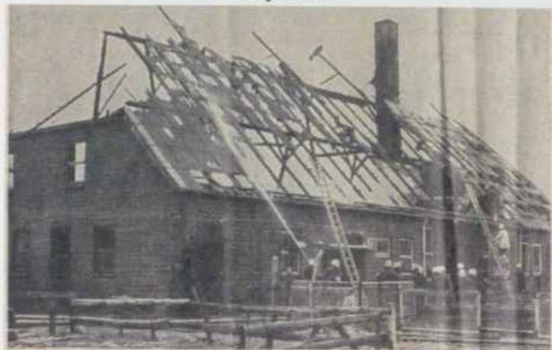
Der Dachstuhl des Carstens-Hofes war total verwüstet worden. Er wurde nach Abbläsen des Brandes eingestürzt. Das Erdgeschoss blieb erhalten.
