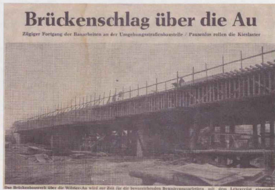
Das Brückenbauwerk über die Wilster-Au wird zur Zeit für die bevorstehenden Betonierungsarbeiten mit dem Lehrgerüst eingeschalt.
