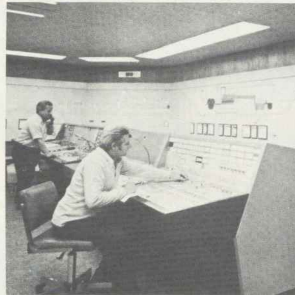
Abb. 54 1973, Zentraler Leitstand der Zementdrehöfen 9 und 10 des Werkes Alsen-Breitenburg Werk Lägerdorf.
